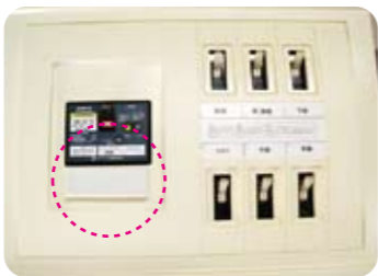
カバーの上から貼る場合は、できるだけ主幹ブレーカーおよび漏電ブレーカーの近くに貼り付けてください。
